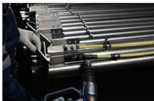
Контроль затяжки гаек болтового соединения динамометрическим ключом и усадка термоусадочной трубки для защиты соединения медного отвода и электрода
